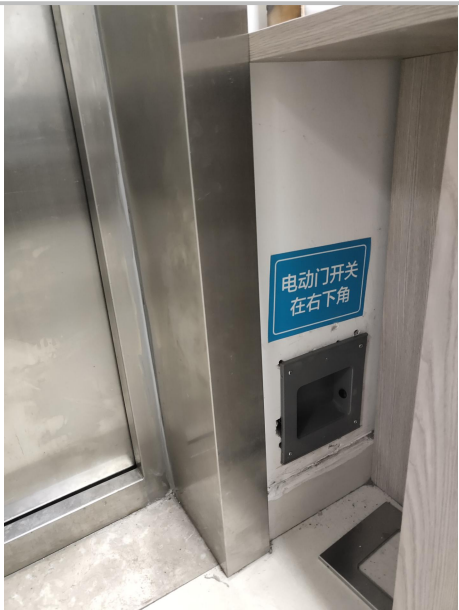
控制室防护门脚踏开关处
